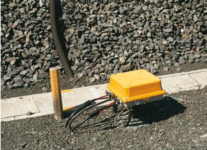
Afbeelding 18. Trackside Connection Box met tuner
